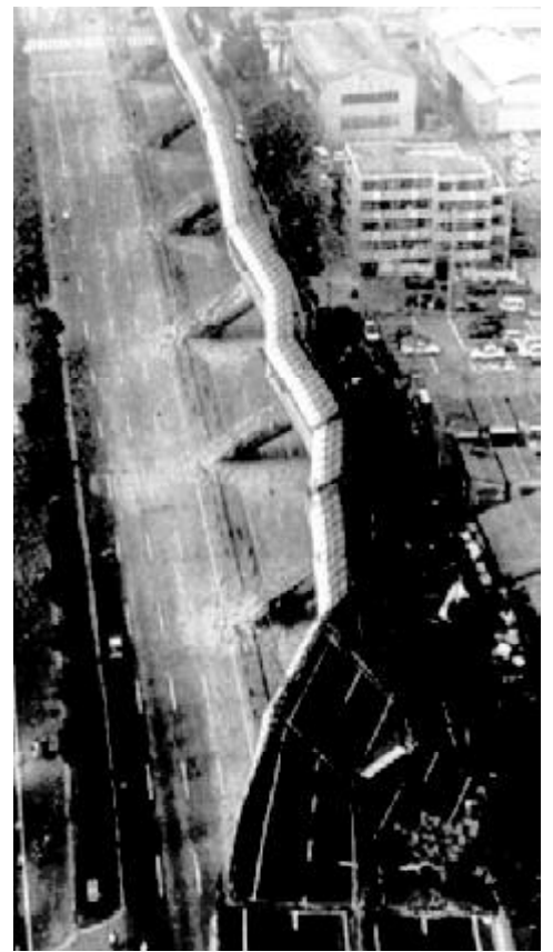
Figura 21. Colapso lateral del viaducto Hanshin, Japón, 1995.
