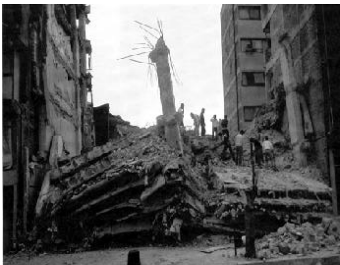
Figura 40. Aquí la columna de apoyo perforó, como un punzón, las losas de hormigón derrumbadas unas sobre otras. Ciudad de México 1985.
