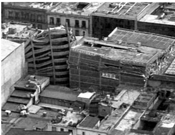
Figura 39. Estacionamiento derrumbado como un castillo de barajas también por falta de rigidez. Ciudad de México 1985
