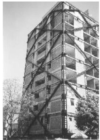
Figura 50. Rehabilitación sísmica en un edificio de la Ciudad de México. Para estudiar su comportamiento se instalaron acelerógrafos en sus diferentes niveles (CENAPRED)
