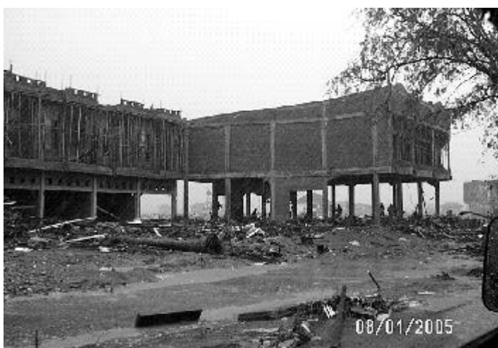
Figura 31. Daños por tsunami en muros de planta baja, en Banda Aceh
