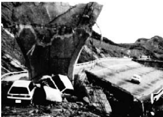
Figura 20. Colapso de un viaducto en Northridge, C.A., 1994.
