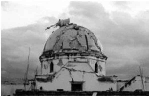
Figura 2. El sismo de junio y septiembre de 1999, con epicentro en el sur del estado de Puebla, produjo graves daños especialmente en inmuebles históricos e iglesias.
